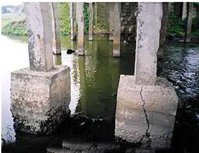
Рисунок 1.3. Разрушение железобетонных опор моста под действием вод пресного водоема - обтекание средой поверхности конструкции
